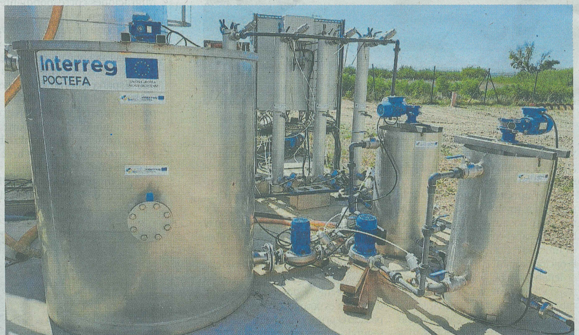
Imagen de la planta pionera instalada en la depuradora de NILSA en Tudela.
